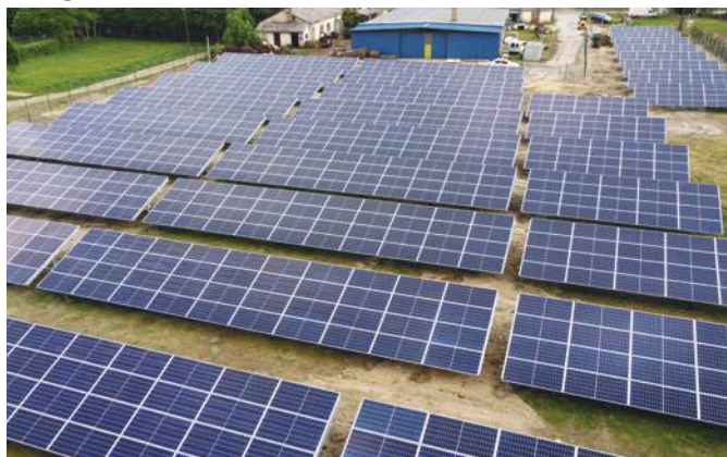
Óhíd (saját erőmű) 500 kWp
