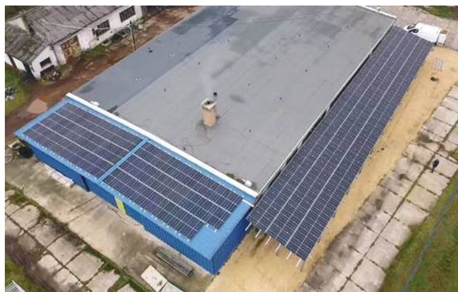
Óhíd (saját erőmű) 50kWp
